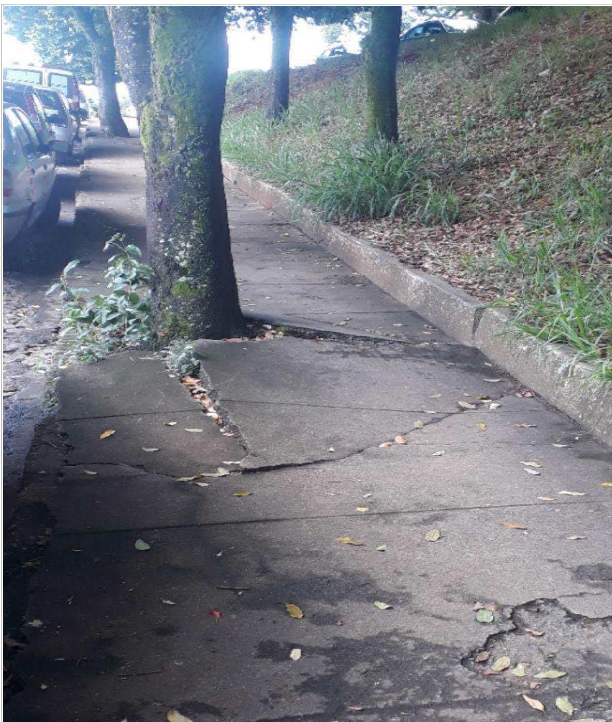
Foto de calçada com trincas, sem acessibilidade e com obstrução do caminho na Avenida Ari Marques
